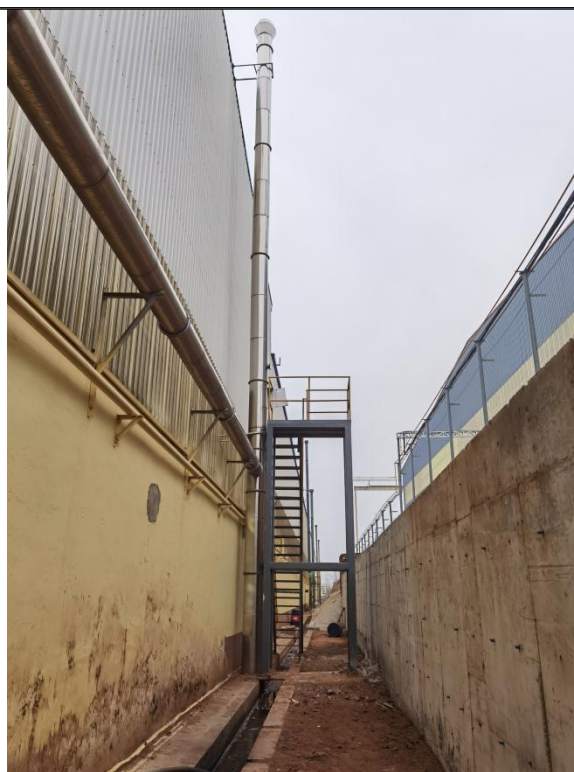
冷镦、网带炉废气排气筒
