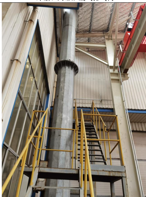
抛丸废气排气筒
